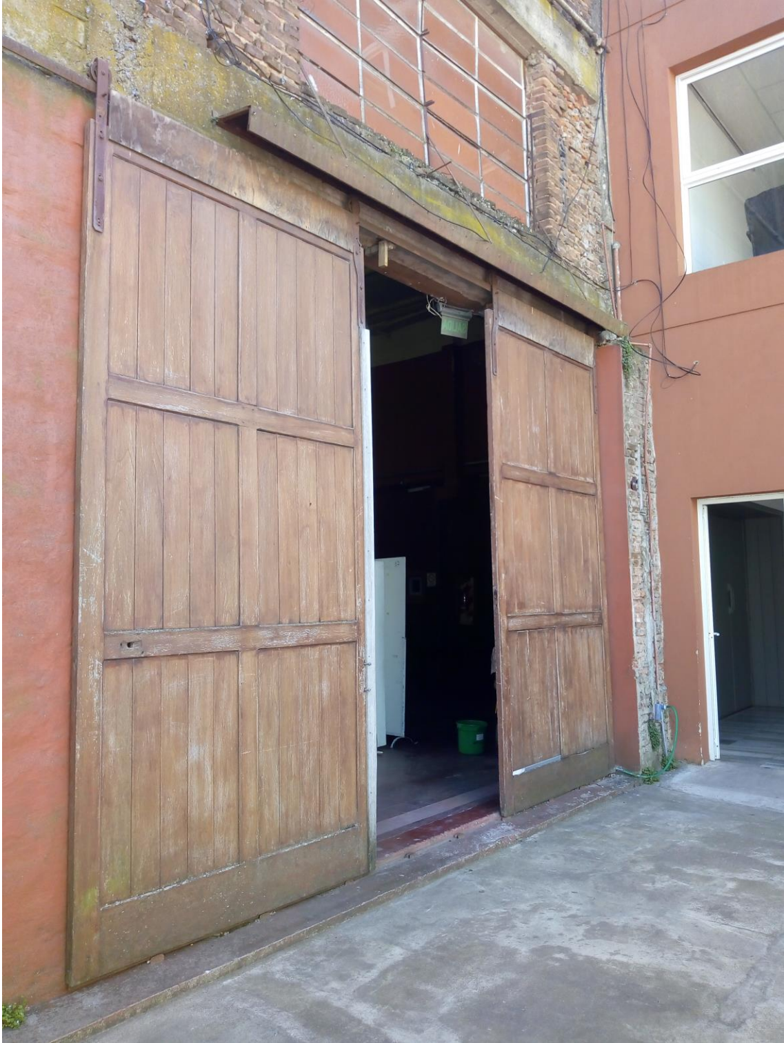
Puerta de acceso gimnasio a reemplazar
