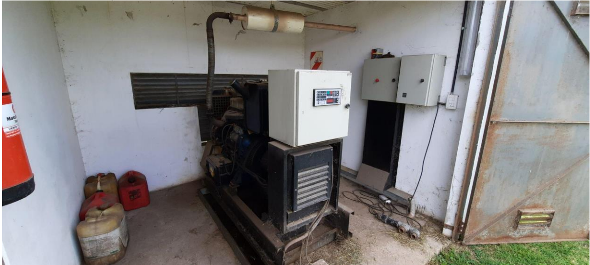
Vista general de generador, tablero y espacios.
