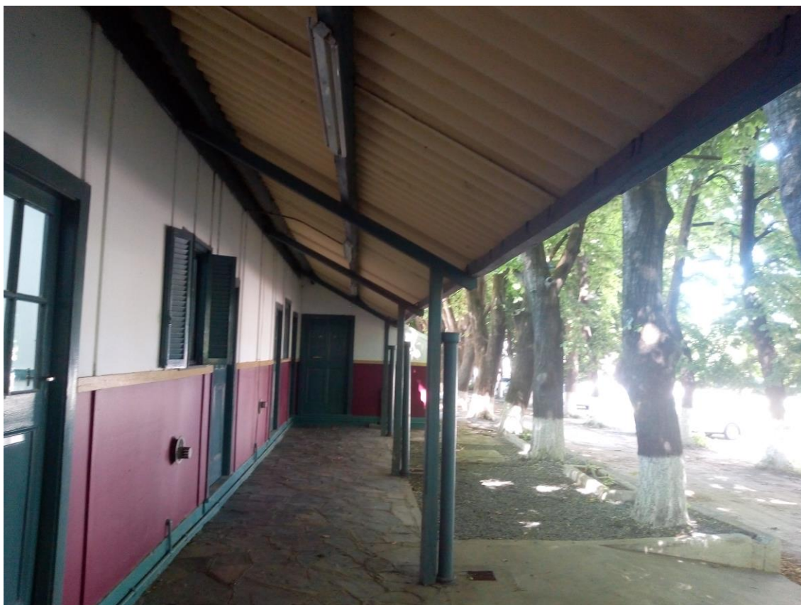
Galería hacia preceptoria (ubicación de Tablero general)
